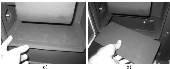
Figura 138 – Limpieza del interior de la estufa
