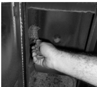
Figura 50 - Limpeza do interior da salamandra a água
